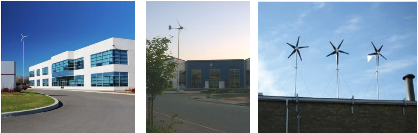
Installation du type Commercial ou Industriel
