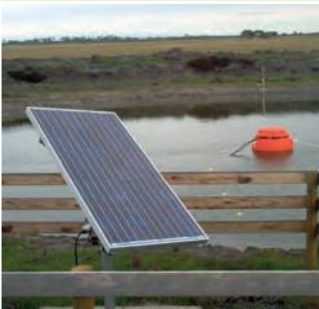
Pompage en surface
